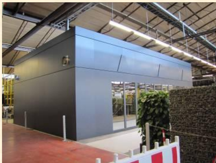
Raum-in-Raum-System einschließlich Innenausbau in nicht brennbarer Ausführung
